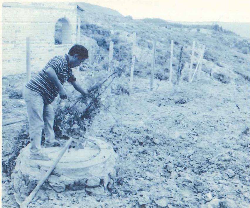
Pozo de revisión
